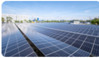
Sembcorp Tuas Solar Farm
